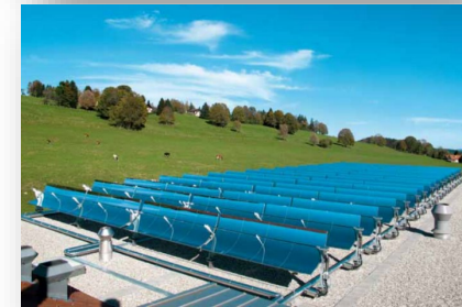
Vereinzelt Anlagen für Wärmeverbunde und Industrie
